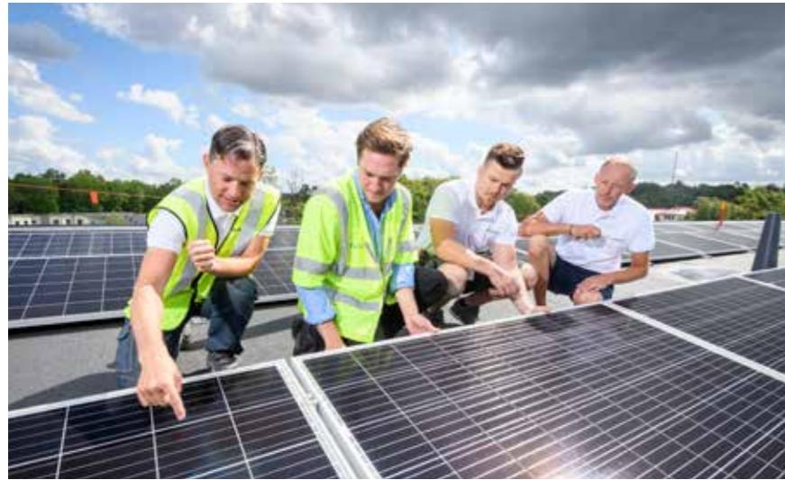
Från vänster: Mikael Olsson (Wästbygg), Martin Everbring (Förbo), Joshua Ormsby (Fyrstads el) och Vytautas Dubauskas (Vegasolar). "Det är viktigt med ett fungerande samarbete mellan oss och bygg-entreprenören", säger Martin. "På Tallspinnaren har samarbetet fungerat väldigt bra och vi har samtidigt haft kul tillsammans på vägen".
